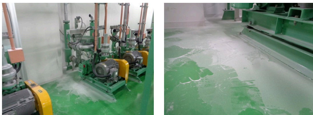
図2 原料輸送設備周辺におけるPE粉体の飛散および堆積状況
