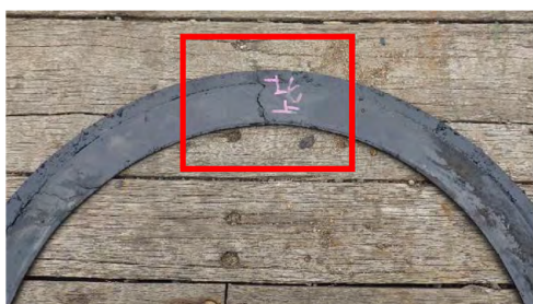
フランジ45：上部に切れ目あり
