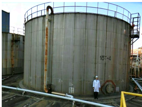
(a)タンク外観
