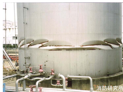
図2 1995年兵庫県南部地震の際に発生した石油タンクの側板座屈
