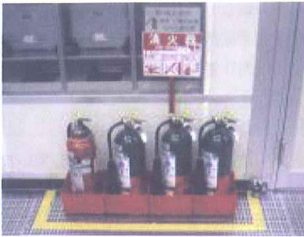
消火器の設置
