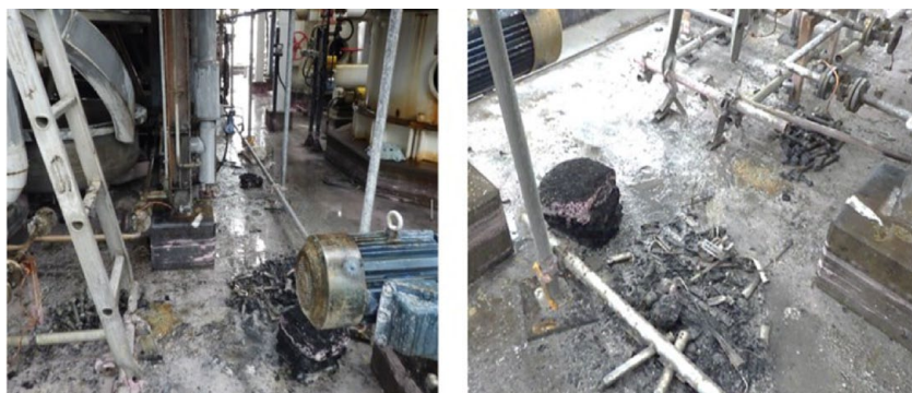
写真3 隣接する施設の焼損状況
