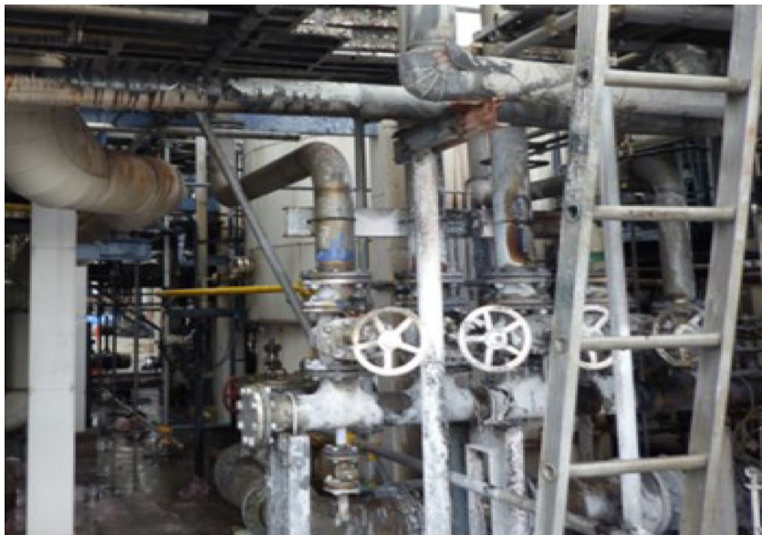
写真2 メタノール蒸発器周りの焼損状況
