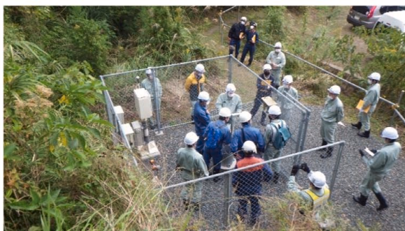
図8 地下水位観測孔設備の全景
