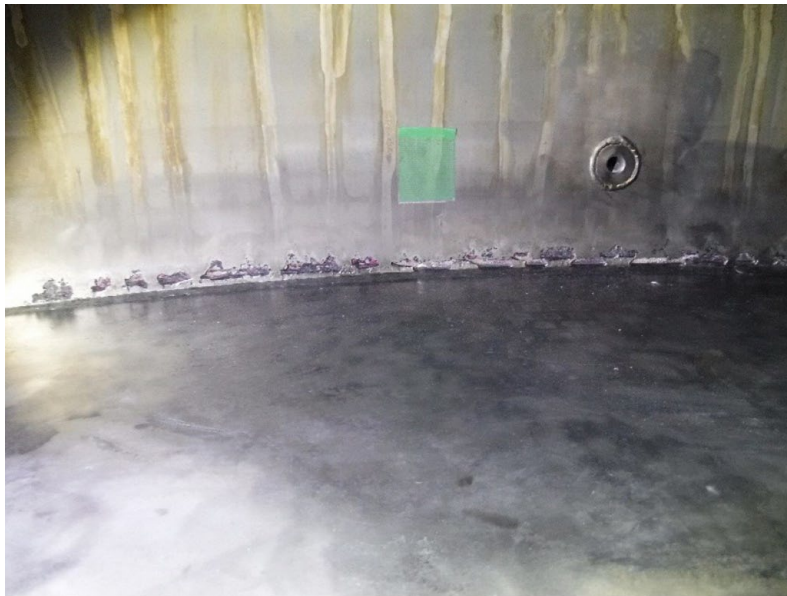
【写真7 隅肉溶接線近傍の腐食の状況】
