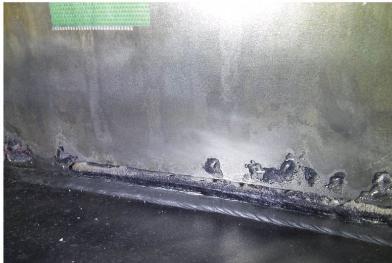
【写真3 隅肉溶接線側板側近傍の腐食の状況】
